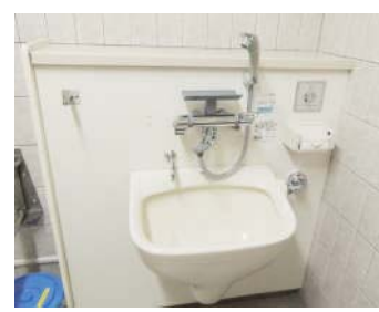
▲オストメイト対応トイレにはシャワー付き流し台、化粧鏡、カウンターなどの設備が整っています。
