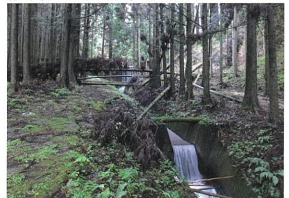
(洪水害の爪跡が残る現場の様子)
