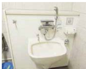
▲オストメイト対応トイレにはシャワー付き流し台、化粧鏡、カウンターなどの設備が整っています。
