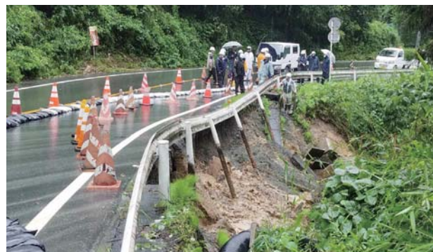
▲国道301の土砂崩れ （現在、交通規制はありません）
